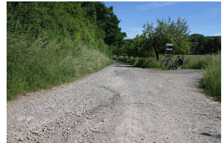
Blick talwärts auf die Schotterdecke mit Auswaschungen mit losem Schotter.
